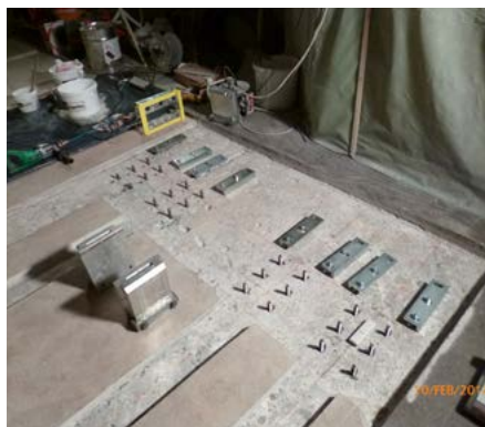
▲ Mise en place des ancrages dans le sens de la précontrainte selon le gabarit
