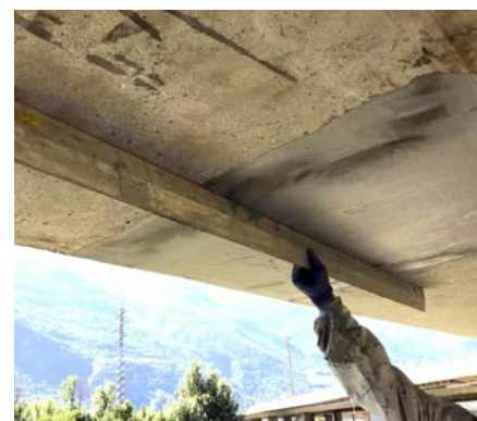
▲ Contrôle de la planéité du support après reprofilage de légères irrégularités avec S&P Resin 220 HP
