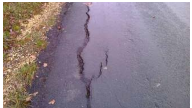
▲ Figure 2: Fissures longitudinale, 4 cm de large
