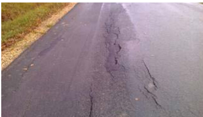
▲ Figure 1: Etat de surface de la chaussée avant réfection, année 2019: Fissures longitudinales, tassement différentiel
