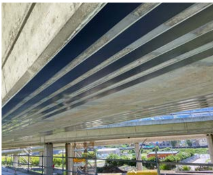
Renforcement passif à la flexion avec des S&P C-Laminates collées en sous-face
